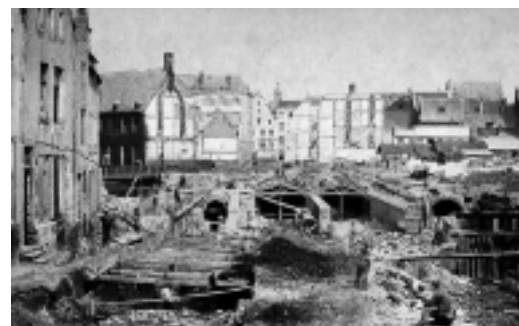
Chantier du voûtement de la Senne, à hauteur de la place St Géry (1868)
