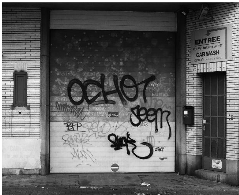
Volet, tagué, du car wash, 15 rue Joseph Hazard ... Depuis des années dans cet état, et malgré une demande de nettoyage au propriétaire !
